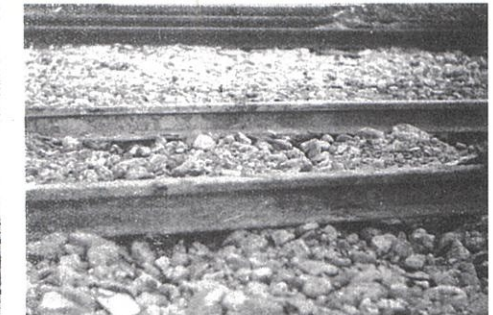
神田駅付近、高架線線路枕木の焼失。(資料15)
