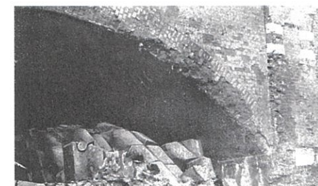
神田駅付近高架橋、火害にあった煉瓦、花崗岩がよく分かる。(資料15)
